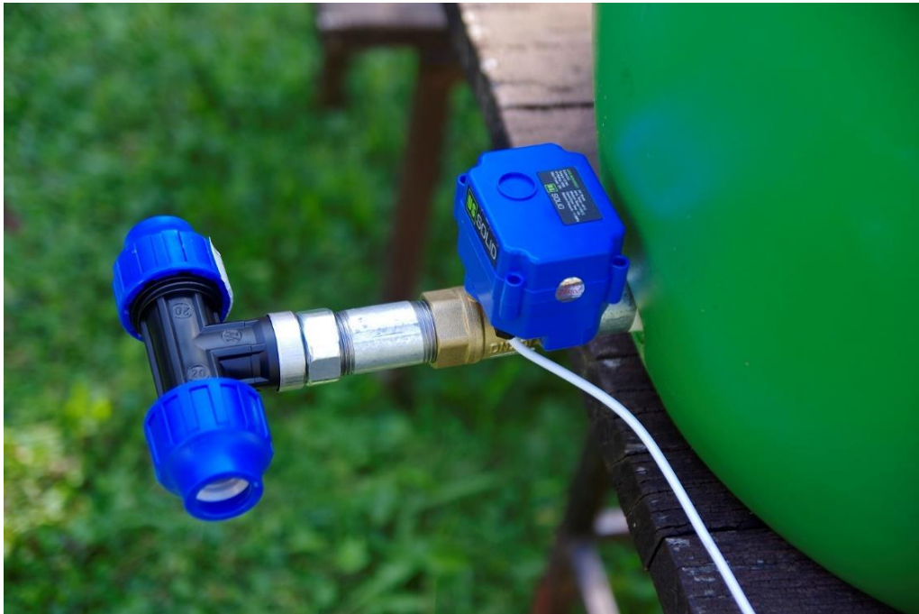
Slika 29 Prikaz ventila na modulu za navodnjavanje
