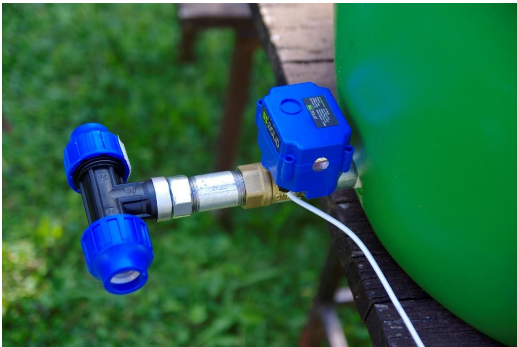
Slika 29 Prikaz ventila na modulu za navodnjavanje
